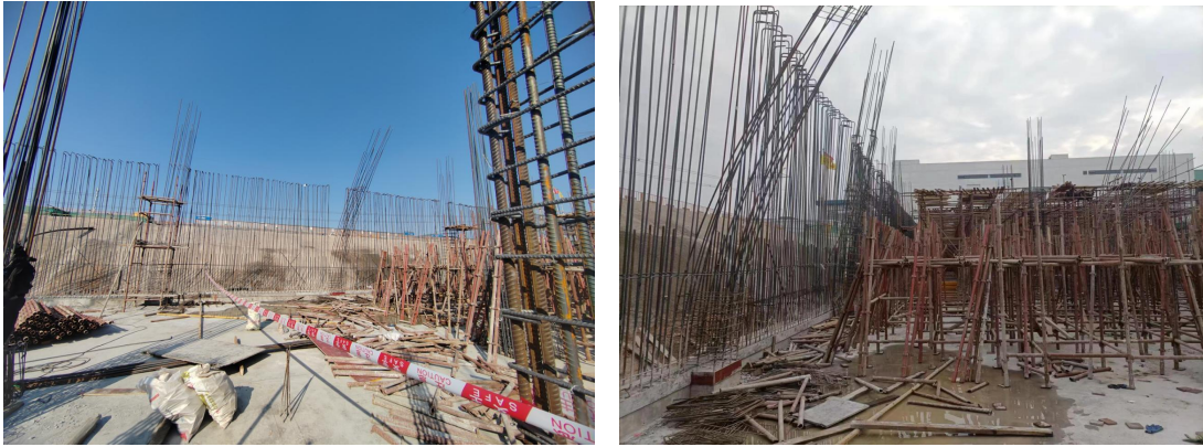
（左图为事发地点作业面概貌，右图为柱钢筋及操作架搭设位置，地面散落钢管）
