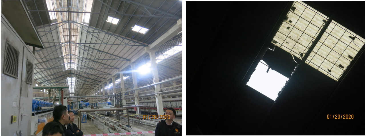
（左图显示釉线和窑炉车间【浅灰色顶棚】、抛光车间【深灰色顶棚】相连概况，右图显示事发后抛光车间顶棚留下的长方形窟窿）
